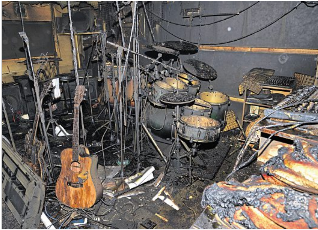
Ein Feuer hat den Probenraum der Band Eastwind komplett vernichtet. Die Instrumente und das Equipment der Musiker befanden sich im Keller des Einfamilienhauses von Claus-Dieter Webers in Schlicht. Dort machten die Bandmitglieder das letzte Mal am Sonntag Musik. Heute wäre die nächste Probe gewesen. Bilder: Hartl (2)
