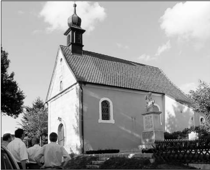
Deutlich sichtbar waren für die Mitglieder der CSU-Markttratsfraktion die Risse in der Fassade der Süßer Kapelle. Bild: pm
